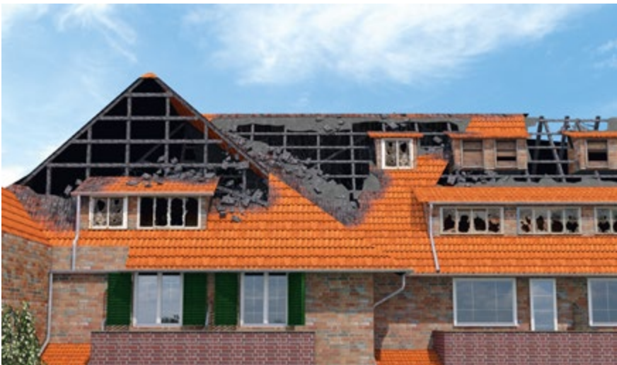
Abb. 23 Gebäude nach einem Dachstuhlbrand
